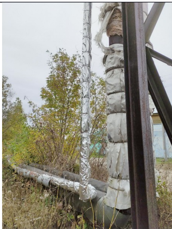
Рисунок 1.2 - Участок тепловой сети 5тк-12
